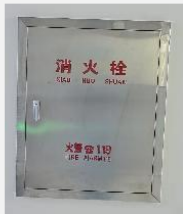
超净间消防栓
